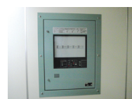
火災警報集中管理盤
